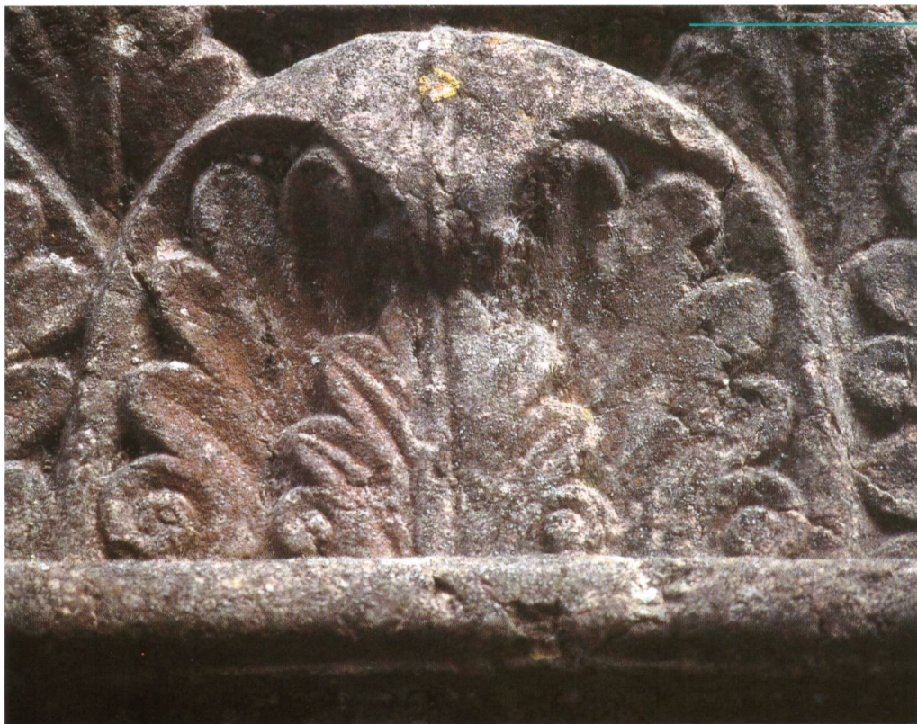
Abbazia di Pomposa. Patine biologiche presenti nelle decorazioni in pietra che ornano il cortile della chiesa.
