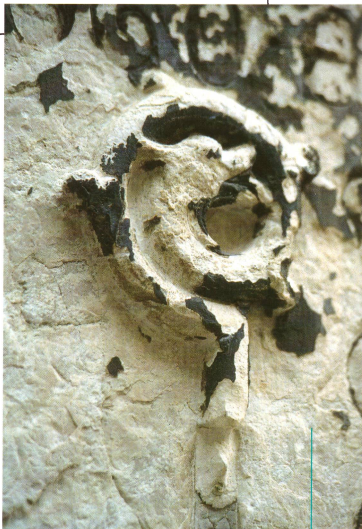
Venezia. Interessante esempio di caduta delle croste nere che hanno lasciato scoperta una superficie calcarea, in gran parte gessificata. Particolare della facciata della Scuola Grande di San Giovanni Evangelista.
