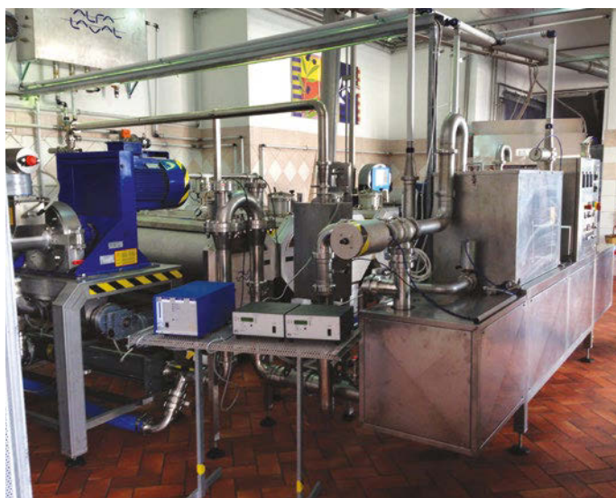
▲ Primo impianto a ultrasuoni in scala reale installato presso l'Oleificio Aloia di Colletorto (Cb).
